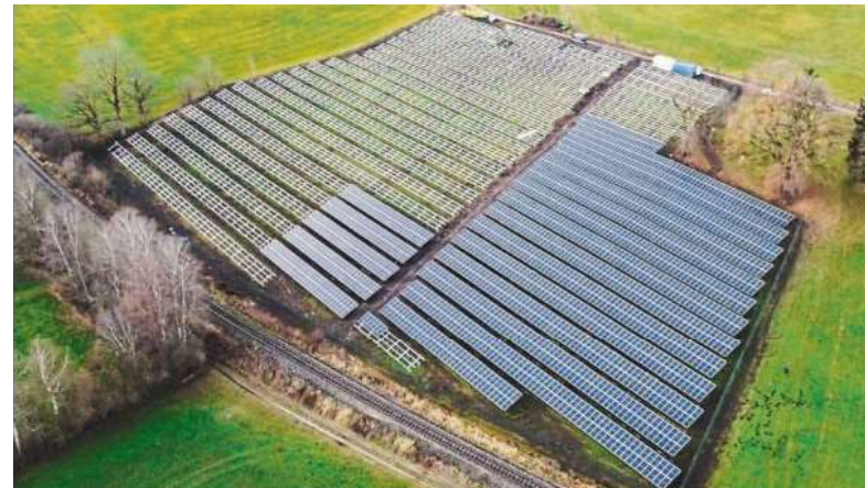
Die Photovoltaikanlage: Der rechte Teil ist fast fertiggestellt, beim linken soll es im kommenden Frühjahr soweit sein.
